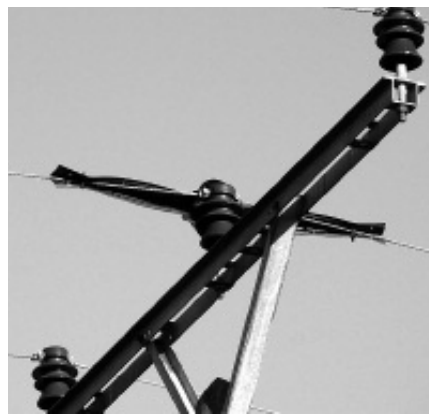
Abb. 5: Schutzhauben auf Stützisolatoren waren ein großer Durchbruch bei der Sicherung von Mittelspannungsleitungen. Als entscheidendes Manko solcher nachträglicher Sicherungen gilt allgemein die geringere Haltbarkeit. DERA8785 bezahlte dies auf einem anderen Mast auf der gleichen Trasse am Rande der Queichwiesen bei Offenbach mit dem Leben.
